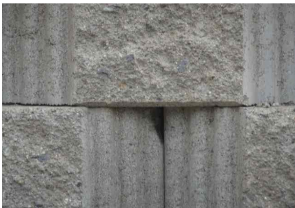
전면부 파손 5구간 0.1m x 0.1m
