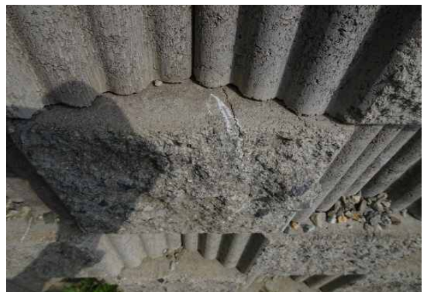
전면부 파손 12구간 0.2mm/0.2m(5EA)
